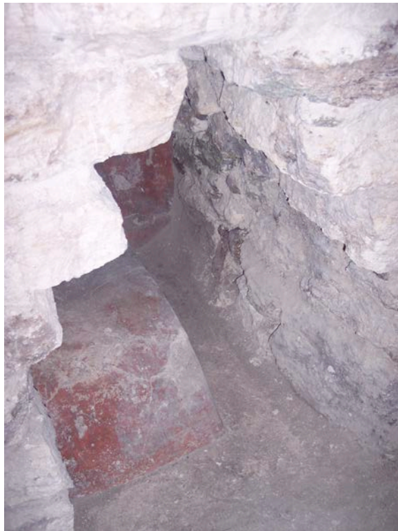
Figura 6. Abertura abovedada en el extremo norte de la grada central (número 4 en planta arquitectónica).
