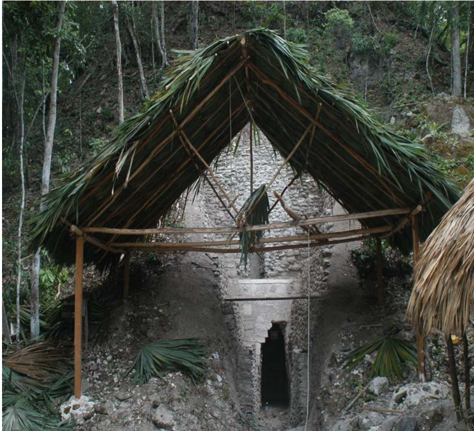
Fig.12. elaboración de la cubierta de protección en la pirámide de Las pinturas.
