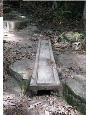
Espigones de madera utilizados para encauzar las correntadas y evitar la erosión, en Tikal
